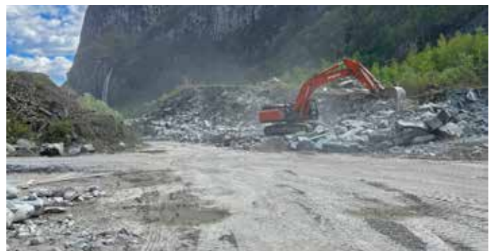
Smaltimento di scarti di cava presenti in alveo nell'aprile 2024.
